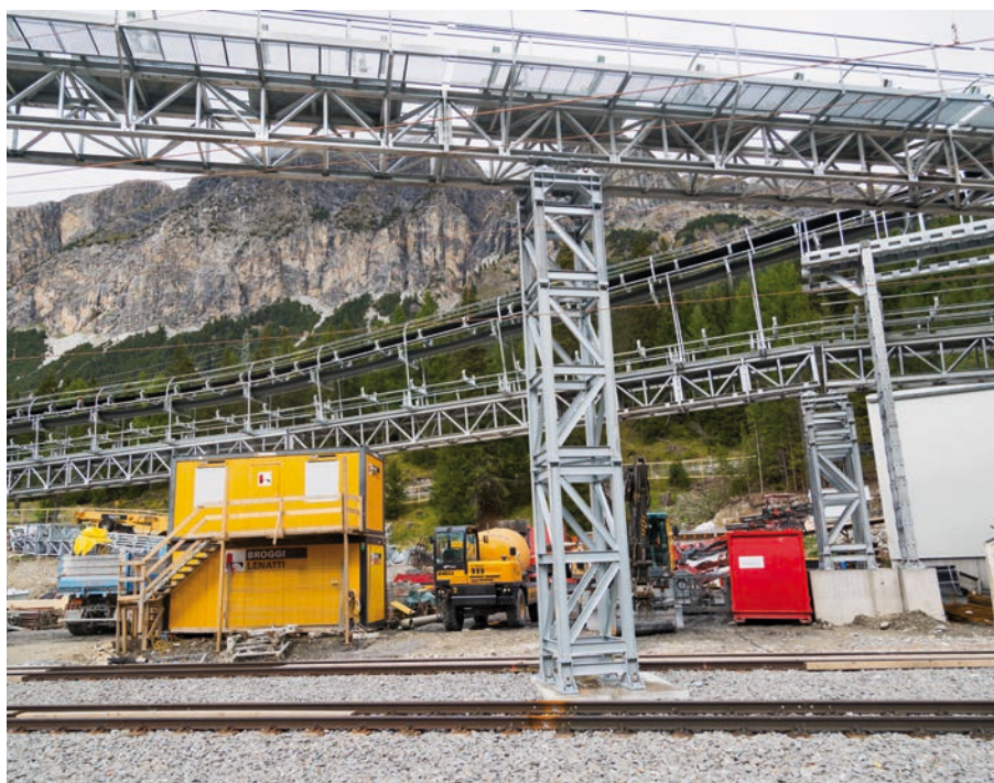
Über Förderbänder wird das Gestein abtransportiert.
